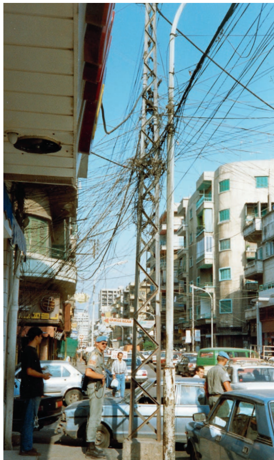
Teleledningar i Beirut
